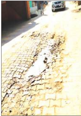
टूटी पड़ी पानी की पाइप लाइन
