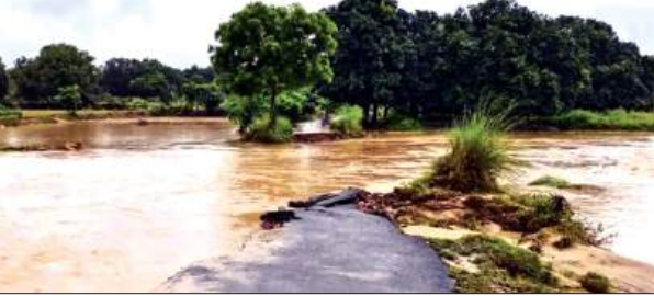
बाढ़ के पानी से कटी पुलिया
